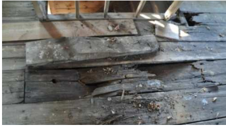
Şekil 20. Mahfil Kotu Ahşap Elemanlarında Bozulmalar
