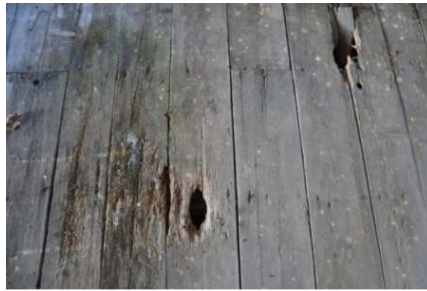
Şekil 22. Mahfil Kotu Ahşap Elemanlarında Bozulmalar
