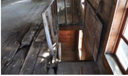
Şekil 19. Mahfil Kotu Ahşap Elemanlarında Bozulmalar
